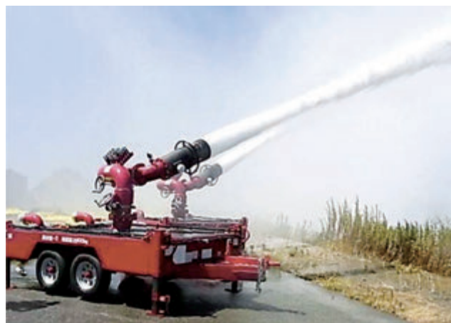
大容量泡放射システムによる放水訓練 (大阪・和歌山広域共同防災協議会)
